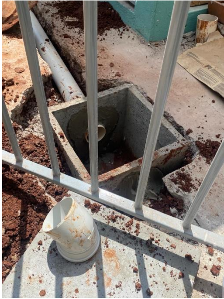
Caixa de Passagem
