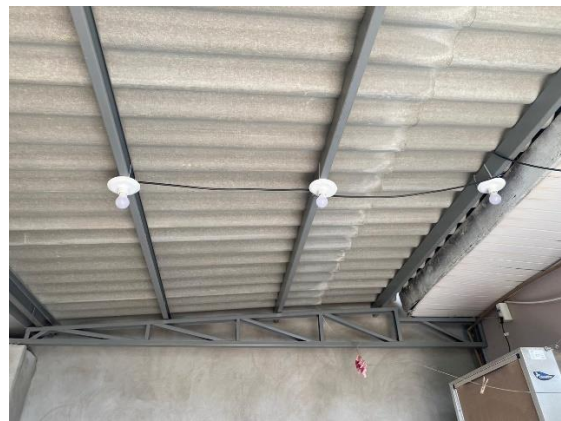
Instalação elétrica (lavanderia)
