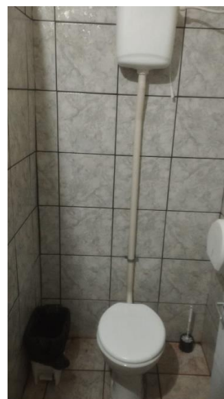
Vaso sanitário novo
